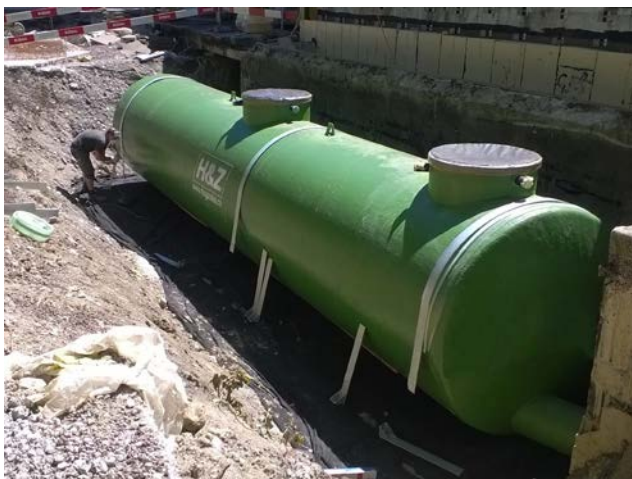
Tank mit direkter Verbindung ins Haus Citerne avec connexion directe à la maison
